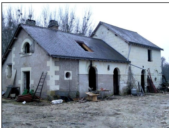
Un ancien moulin, aspect extérieur avant intervention : portes et fenêtres sont manifestement à remplacer.
