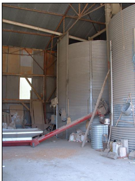
Une installation complexe, avec silos, élévateur, et dispositif de séchage du grain, à la Brosserie.
